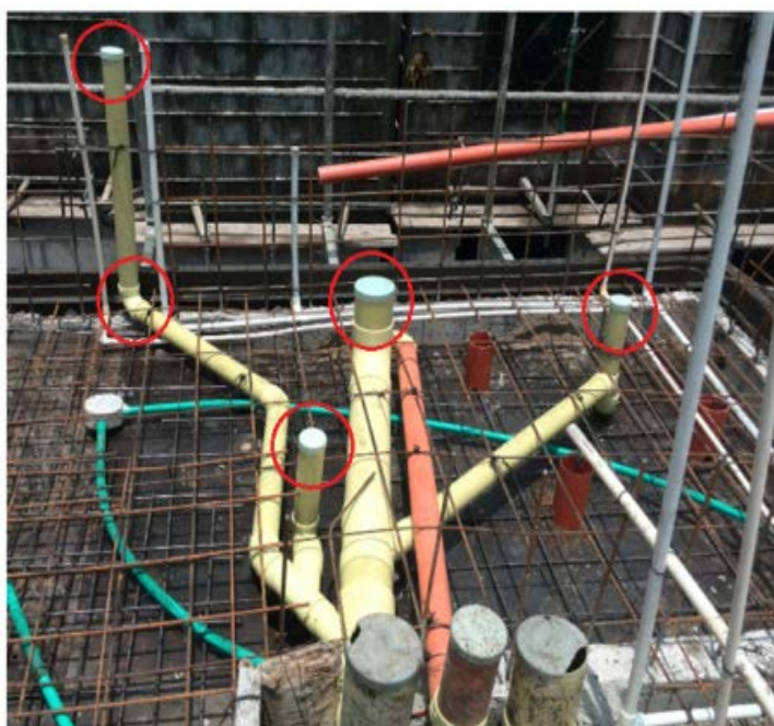
Figura 17. Codos y tapones en parales sanitarios
