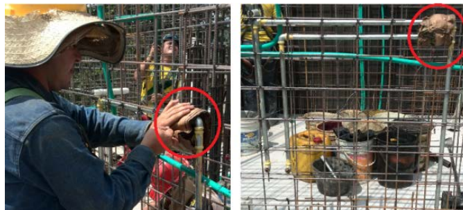
Figura 32. Empapelar válvulas HG en muros
