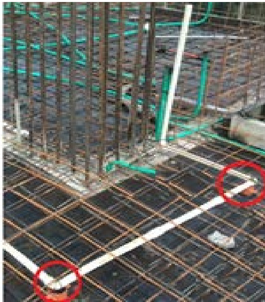
Figura 18. Pendiente del desagüe del punto del aire acondicionado.
