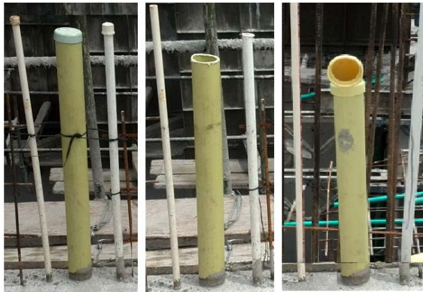
Figura 28. Parales sanitarios prolongados
