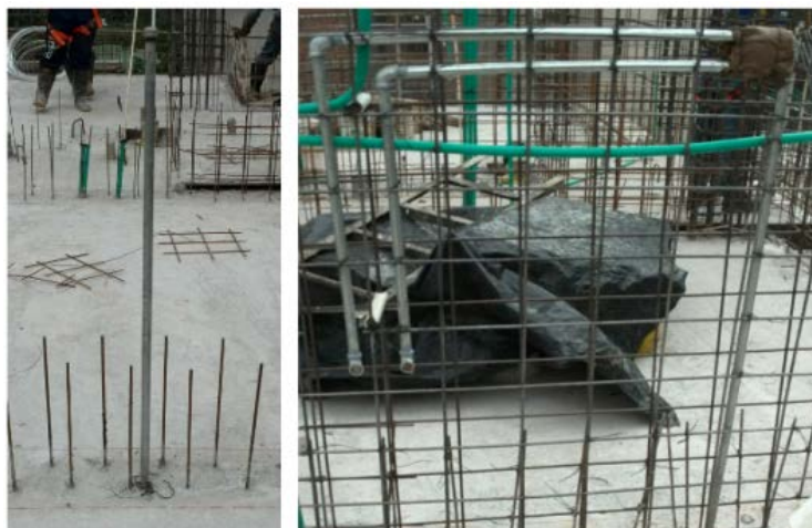
Figura 30. Paralelo tubería de gas
