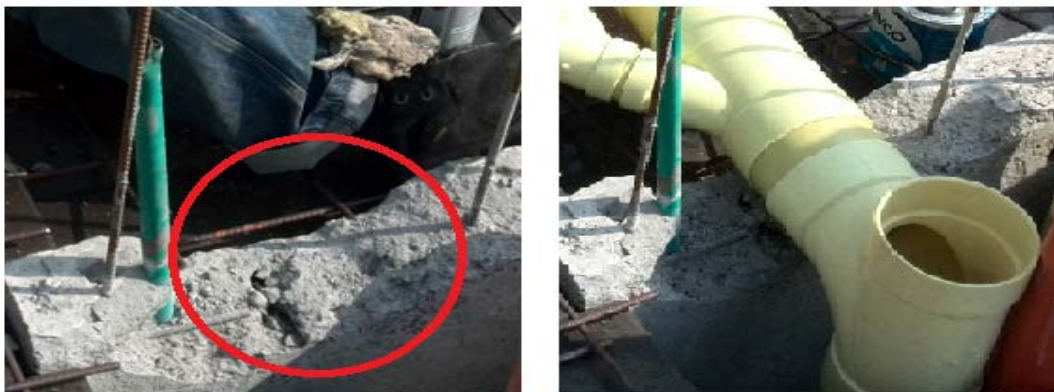
Figura 14. Muro descacilado – tubería sanitaria
