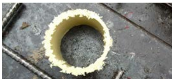
Figura 16. Residuos de material sanitario tras corte
