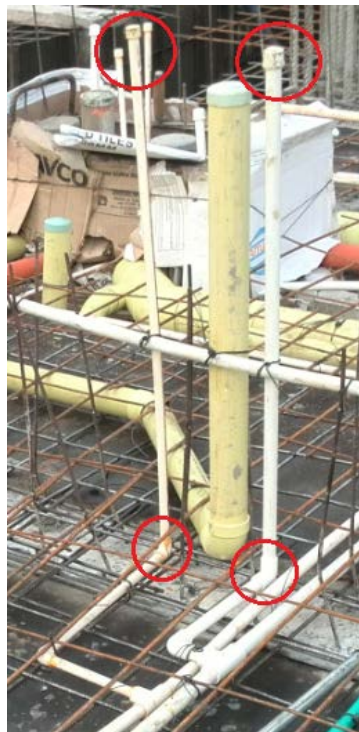
Figura 10. Codos y tapones en parales hidráulicos.
