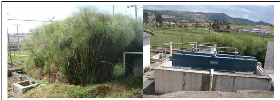
Figura 2. Humedal construido de la planta piloto de tratamiento de aguas residuales domésticas de la Universidad de Boyacá (Tunja).
