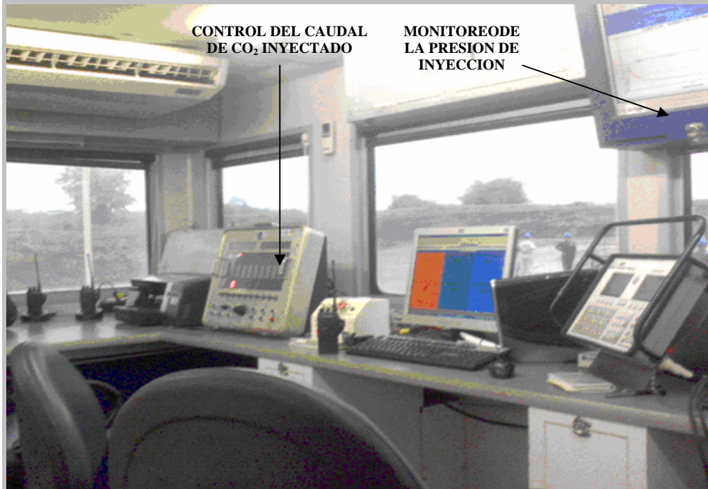
Figura 24. Centro de Operaciones
