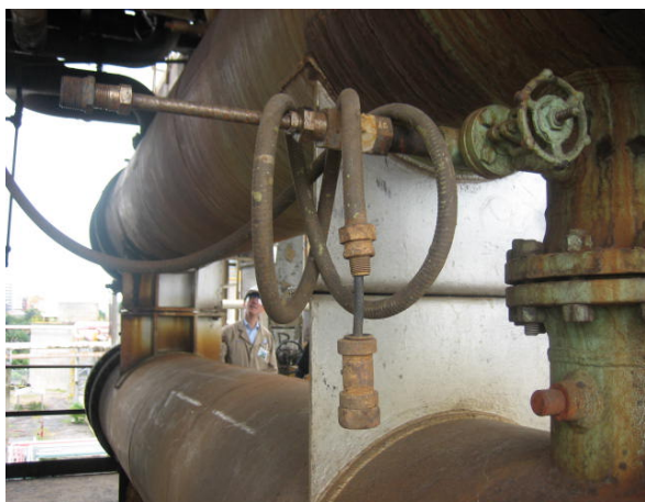
Fig.14 Conectores en mal estado
