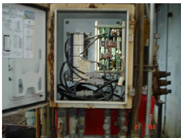
Fig.16 PIM en mal estado
