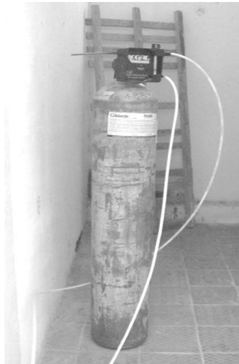
Foto Nª 14 Bala e Instalación del Sistema de Clorado
