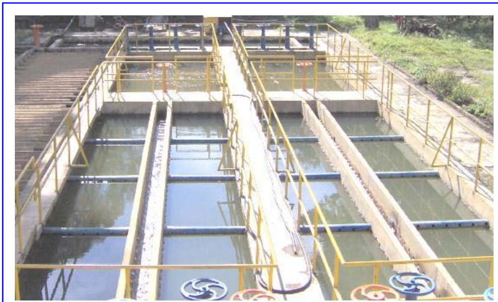
Foto Nª 12 SEDIMENTADORES
