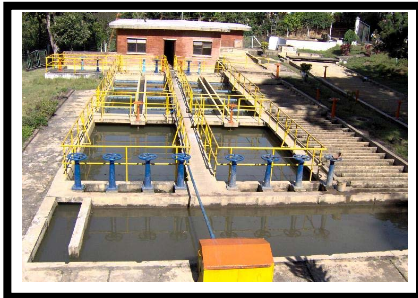
PLANTA DE TRATAMIENTO
