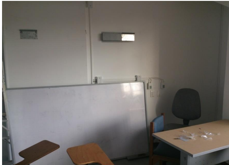
Figura 43. Puesta de mandos telones eléctricos.
