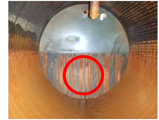
Ñ. Corrosión acanalada provocada por estancamiento de agua.
