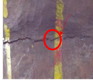
C. Grietas por recalentamiento. (American Petroleum Institute, 2011)
