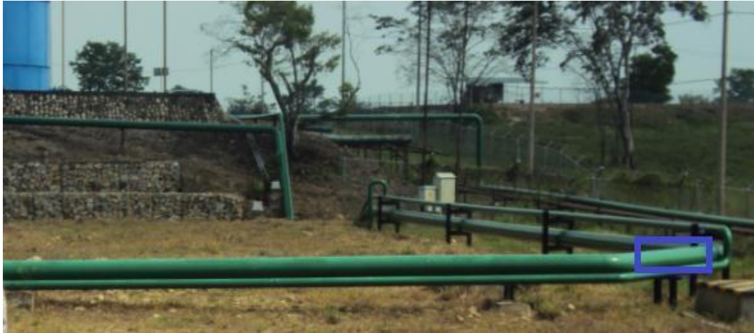
FIGURA 24. Tubería de salida tanque de almacenamiento. Fuente: Los
