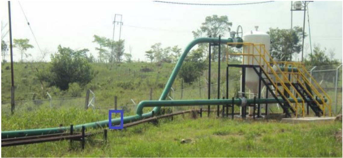
FIGURA 22. Ubicación portacupón a la salida del tanque de desarenado.
