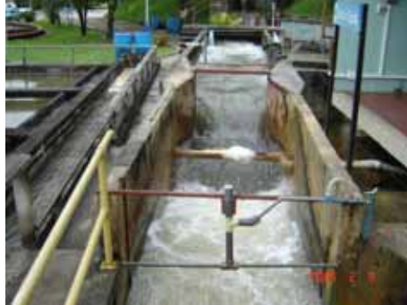
Figura 2. Canaleta parshall de la planta la flora.
