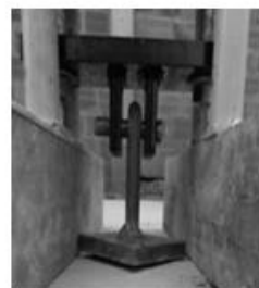
g) Falla por deslizamiento
