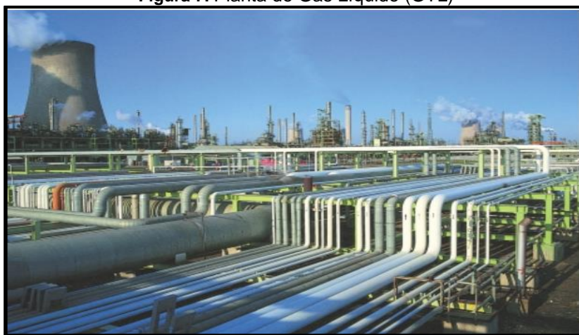
Figura 7. Planta de Gas Líquido (GTL)
