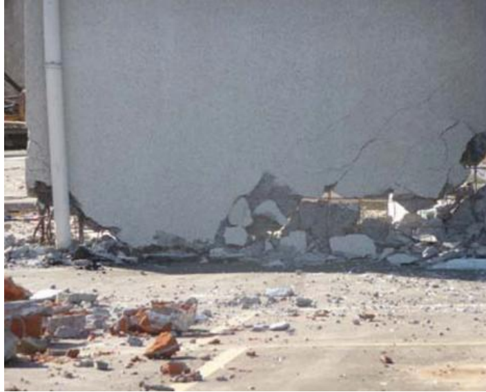
Figura 6. Daño por aplastamiento en muro (Saatcioglu et al., 2012).
