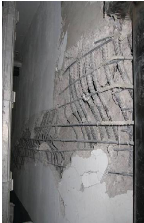
Figura 7. Pandeo por aplastamiento en muro de concreto (Naeim et al., 2011).
