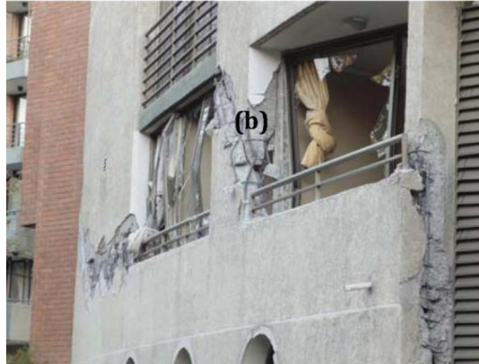
Figura 8. Daño por cortante en una columna (Saatcioglu et al., 2012).
