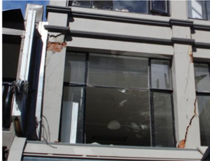
Figura 15. Daño en columnas (Cole, Dhakal, & Turner, 2012).
