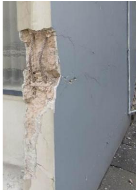
Figura 17. Falla por pandeo y aplastamiento de un muro (Kam et al., 2011)
