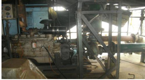
Figura 15. Motor Eléctrico Estación de Bombeo
