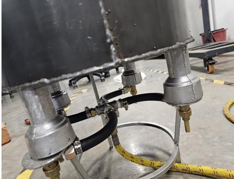
Figura 51. Sistema flexible de distribución de gas
