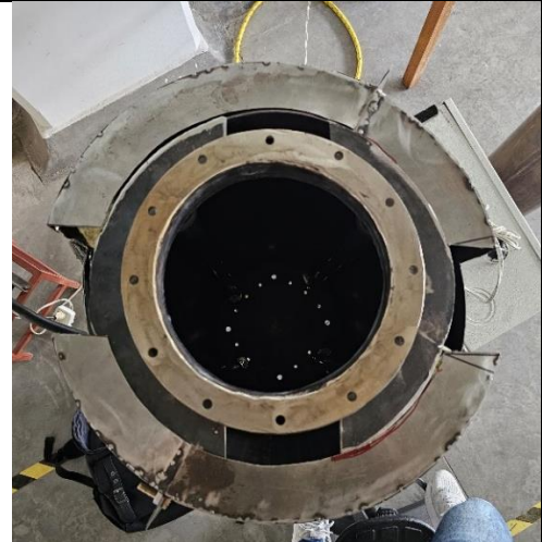
Figura 47. Configuración final para la salida de los gases de combustión.
