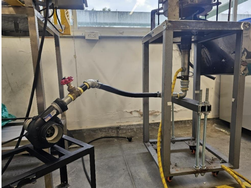
Figura 13. Quemador de gas propano exterior al reactor.
