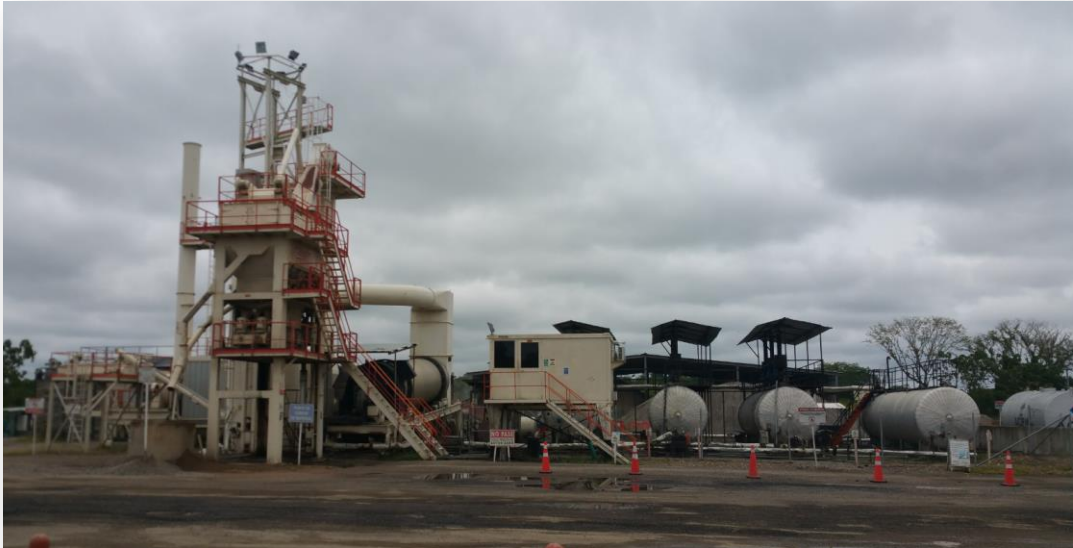
Figura 1. Planta de asfalto de CONSOL – tramo sur.
