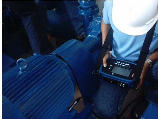
Figura 25. Monitoreo Vibraciones estación de bombeo LA CUMBRE
