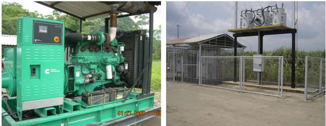
Figura 20. Fuente eléctrica, generador (izquierda) y línea eléctrica con transformador reductor (derecha)
