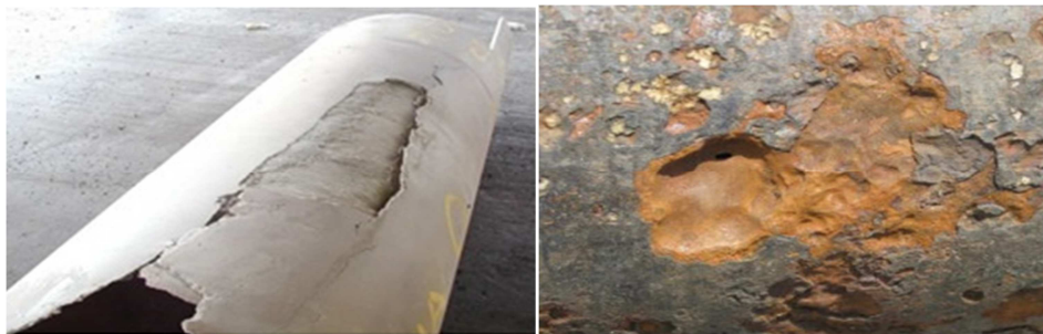
Figura 14. Rotura de oleoductos. (WRC, 2008),(Corrosion & Integrity Solutions, 2009).
