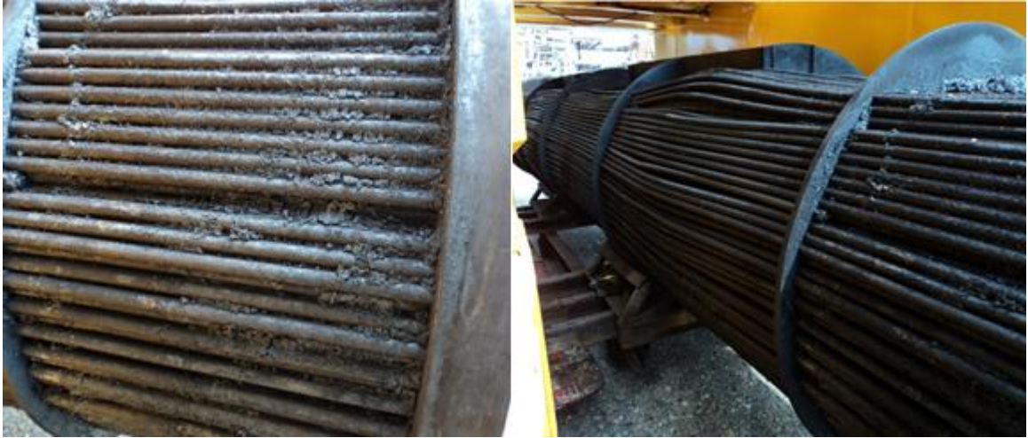
Figura 22. Estado actual del haz de tubos del intercambiador E- 2505A
