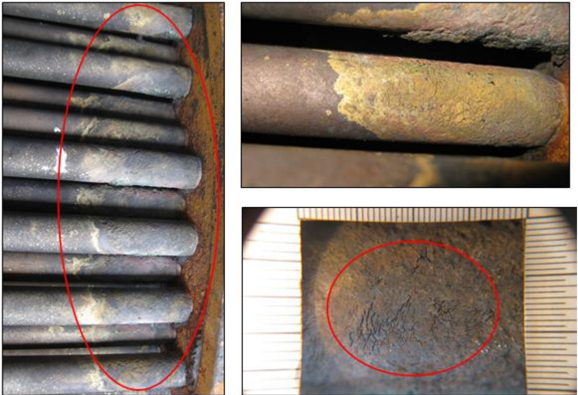
Figura 7. Modo de falla en haz de tubos
