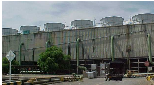
Figura 16. Torre Enfriadora TE 801
