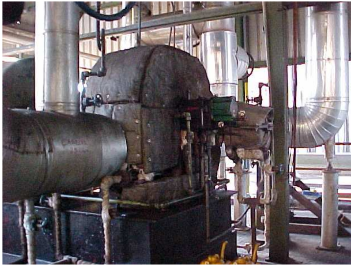
Figura 17. Turbina de vapor NP-811C (Torre Enfriadora 801)
