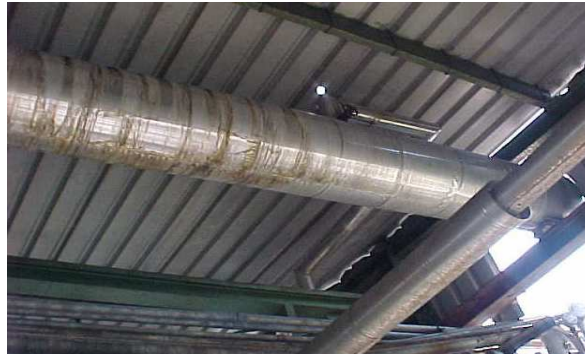
Figura 31. Estado del aislamiento de la instalación local de suministro del vapor a la turbina
