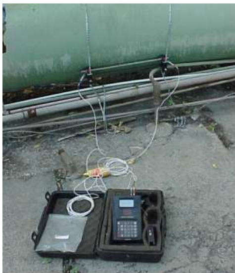
Figura 26. Medición de flujo de la bomba
