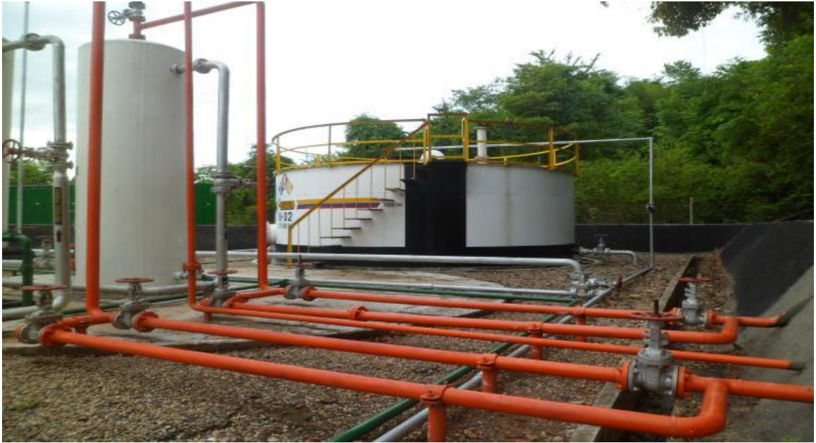
FOTO No. 9 SALIDA DE GAS DE PROCESO – SALIDA I
