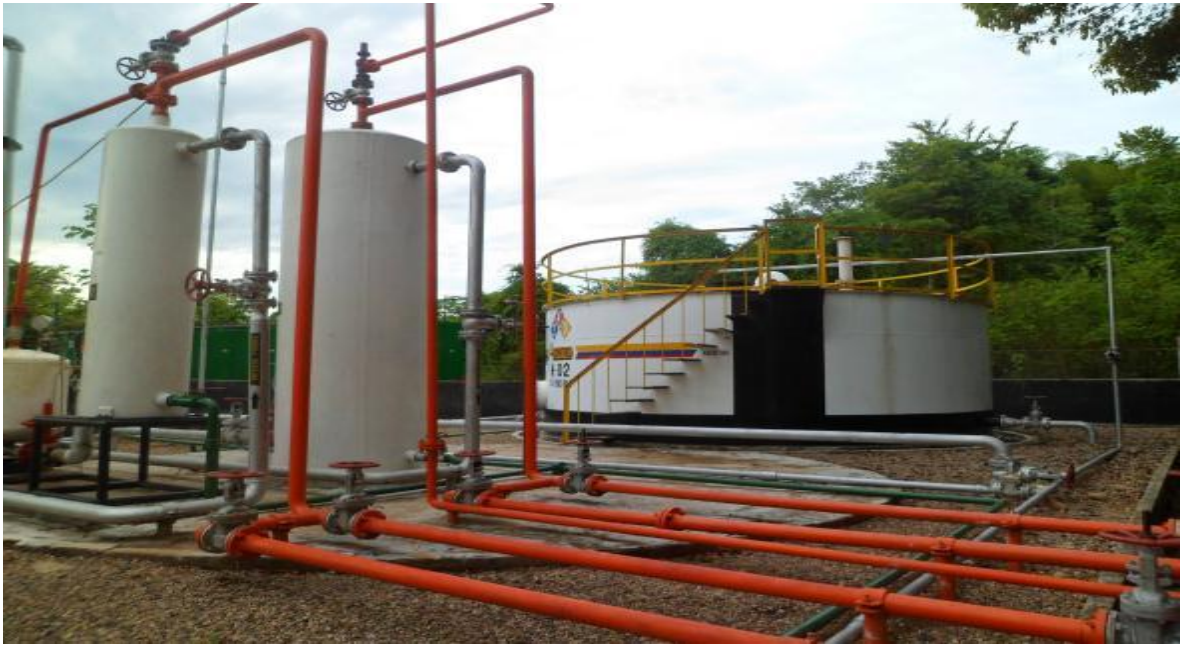
FOTO No. 8 SALIDA DE GAS DE PROCESO – SALIDA I
