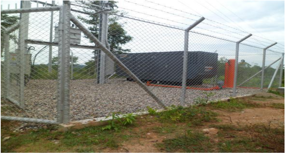
FOTO No. 5 GENERADOR DE ENERGÍA ELÉCTRICA A BASE DE GAS
