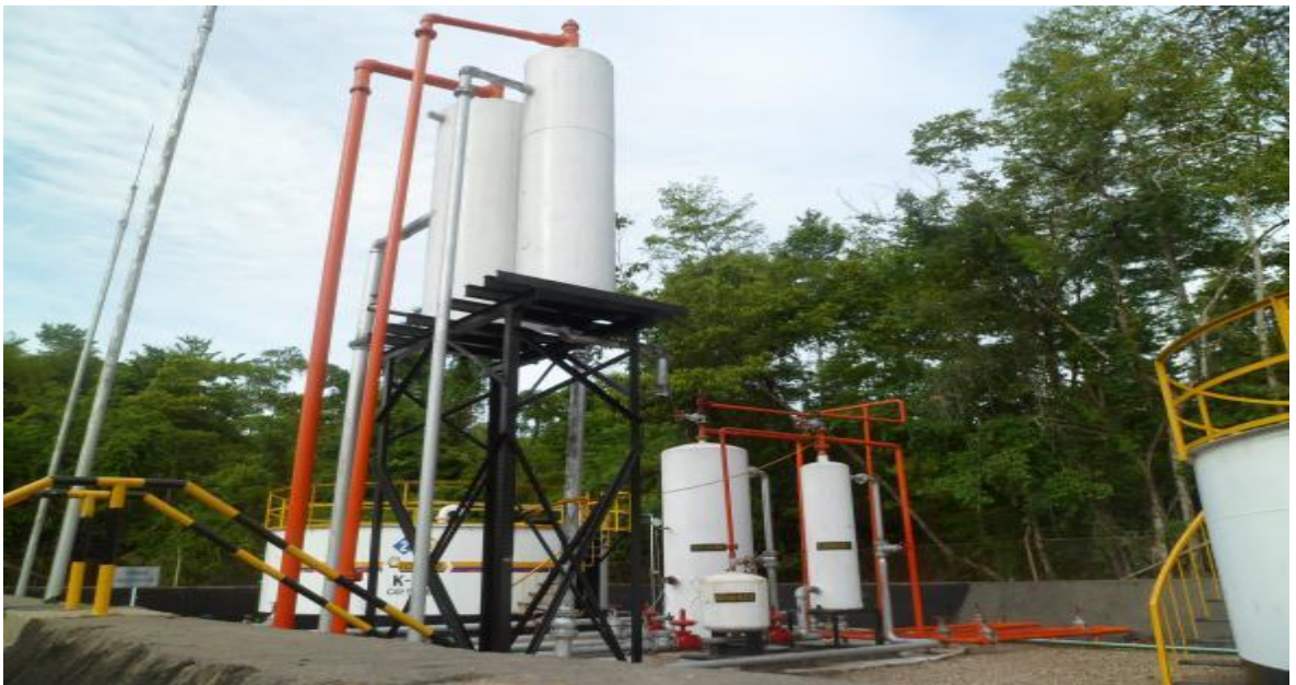
FOTO No. 14 LLEGADA DEL CRUDO A ESTACIÓN - ENTRADA A SEPARADOR BIFÁSICO
