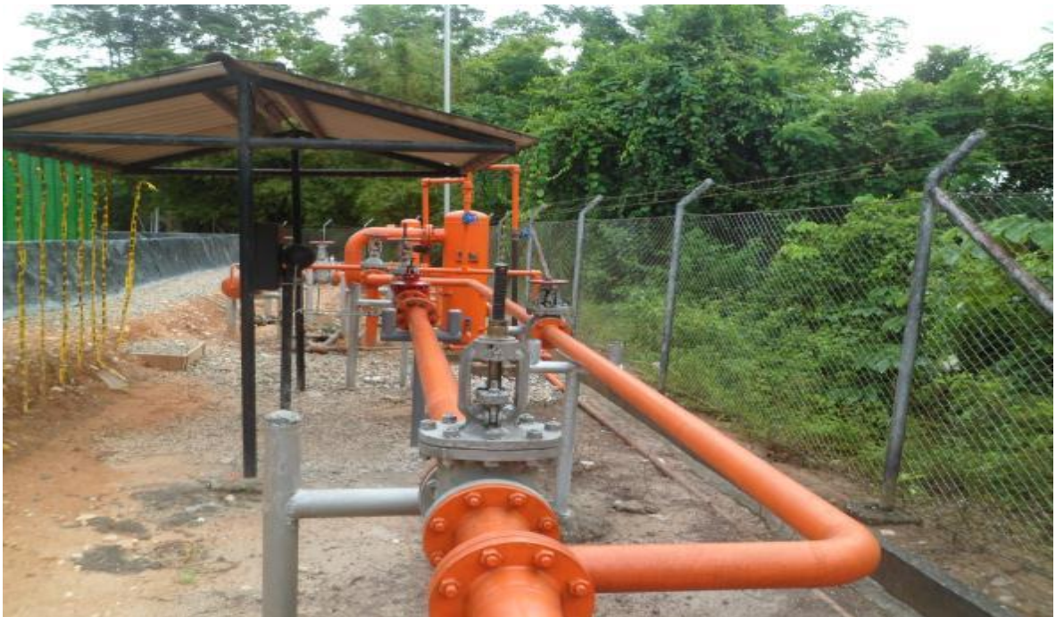
FOTO No. 10 PASO DEL GAS POR UNIDAS DE MEDICIÓN Y DESPACHO A COMPRESOR Y A TEA
