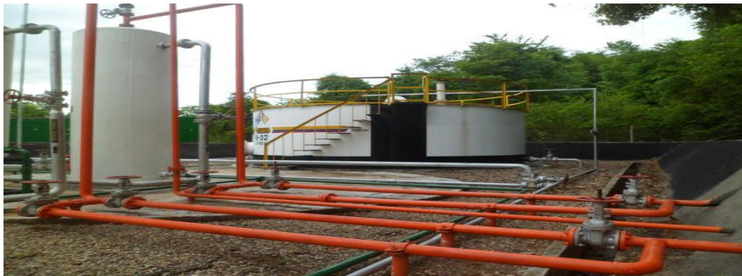
Foto 2 salida de gas de proceso – salida I
