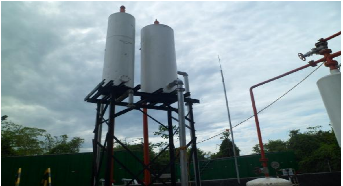
FOTO No. 13 LLEGADA DEL CRUDO A ESTACIÓN - ENTRADA A SEPARADOR BIFÁSICO
