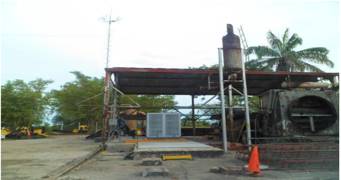
FOTO No. 11 CASETA COMPRESORA DE GAS – DESPACHO A GENERADORES A GAS
