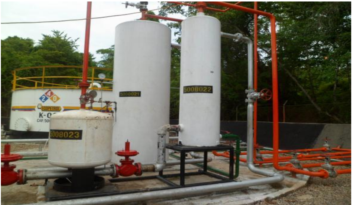
FOTO No. 12 LLEGADA DEL CRUDO A ESTACIÓN - ENTRADA A SEPARADOR BIFÁSICO
