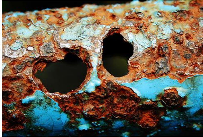
Ilustración 7. Corrosión por picaduras
