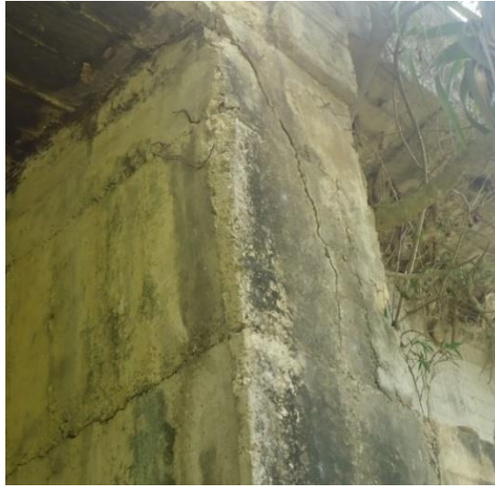
Figura 3. Imagen de la pila central y falla del estribo.
