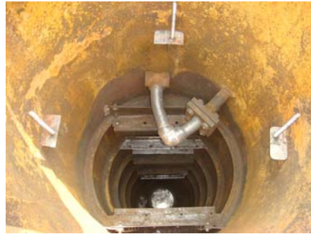
Toma superior de la torre sin platos
