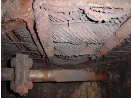
Malla Demister en la sección media de la torre.
