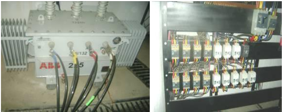
Figura 24. Transformador y Tablero en baja tensión Edf. Ingeniería Química
