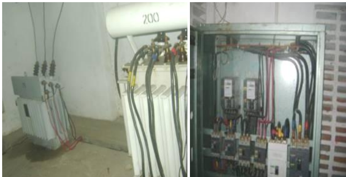
Figura 28. Transformador y Tablero en baja tensión Edf. Administración I
