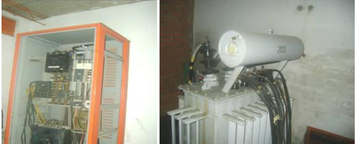
Figura 22. Transformador y Tablero en baja tensión Edf. Planta de aceros
