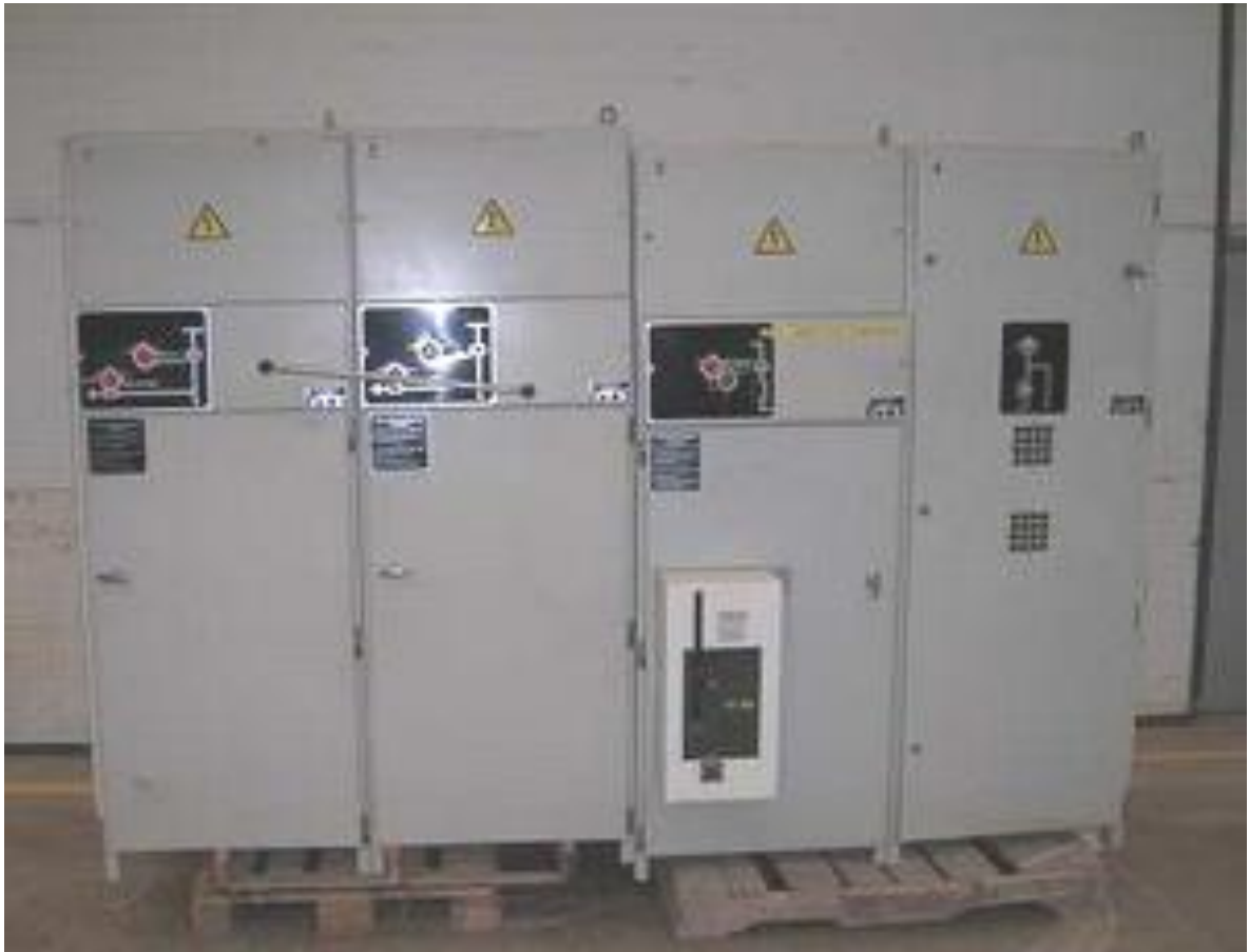
Figura 14. Seccionador tripolar celda compacta con seccionadores en el interior.
