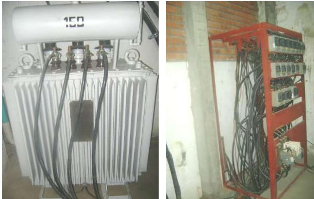
Figura 26. Transformador y Tablero en baja tensión Edf. Ingeniería Mecánica
