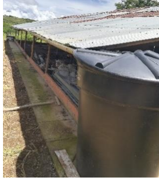
(a) Tanque de agua lluvia
