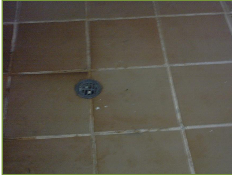
Figura 14. Pisos con rendijas entre baldosas, rejillas en mal estado
