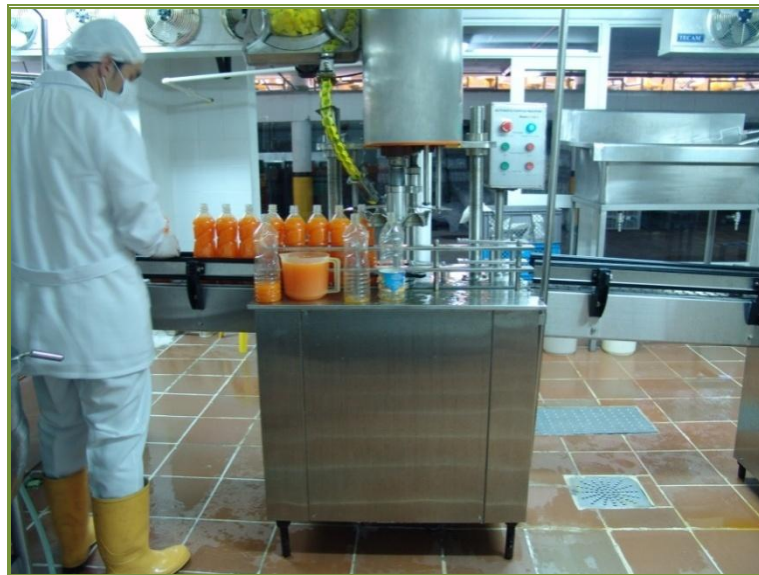
Figura 17. Sala con aire acondicionado y rejillas apropiadas
