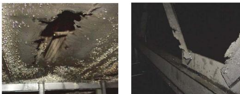
Figura 4. Aspecto de la corrosión en los componentes internos de la torre del proceso.
