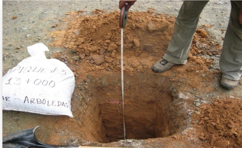
Imagen 6. Apique tomado sobre el K13+000 en la vía Salazar - Arboledas
