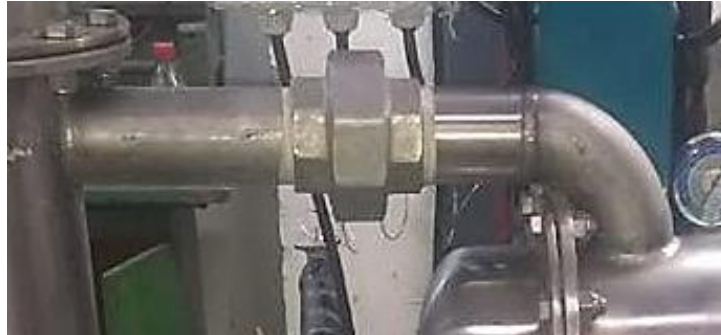
Figura 24. Tubería de vapor.
