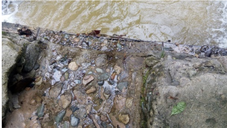
Figura 14. Estado actual de estructura de Protección.
