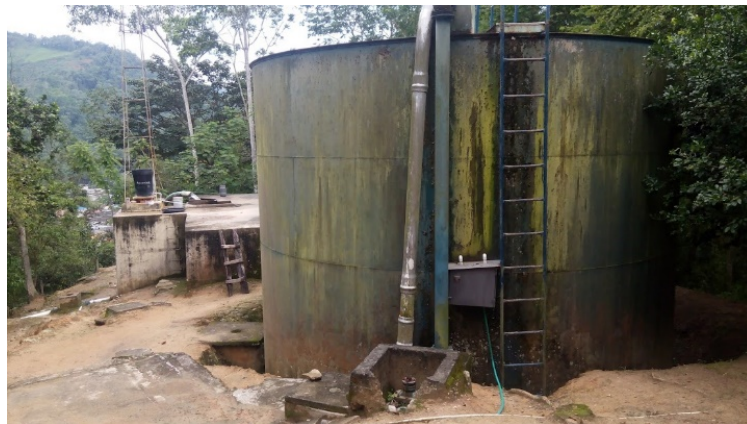
Figura 15. Tanque de almacenamiento.
