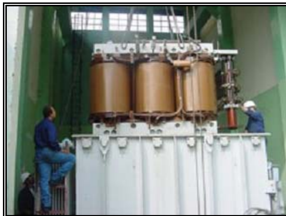
Figura 4. Devanados del transformador
