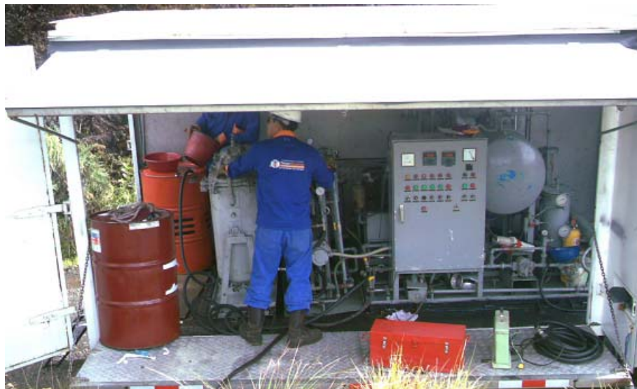
Equipo de tratamiento de aceite Fuente: Transequipos Ltda.
