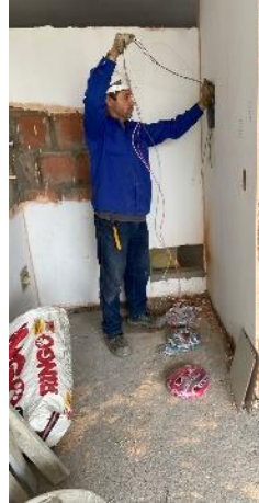
Figura 30 Cableado Eléctrico Apartamentos
