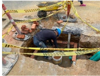
Figura 27 Caja Eléctrica Edificio Akau25
