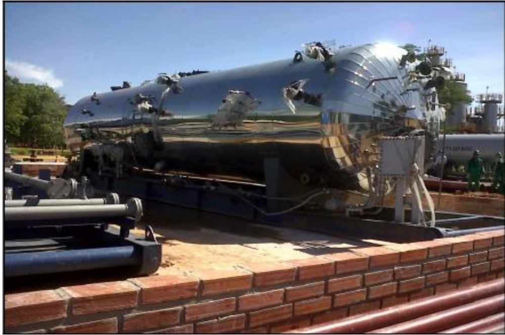
Figura 14: Estación de recolección y tratamiento PTS.
