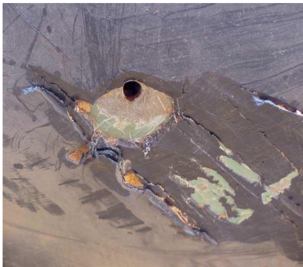
Figura 11. Efecto de la corrosión por picadura
