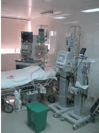
Figura 5. Ventilador fuera de servicio
