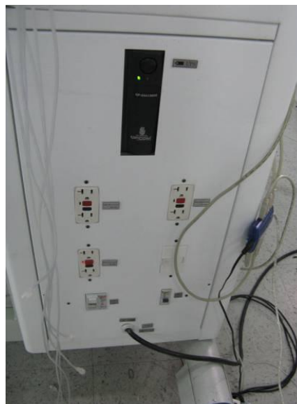
Figura 112. Panel eléctrico UCIM 1200
