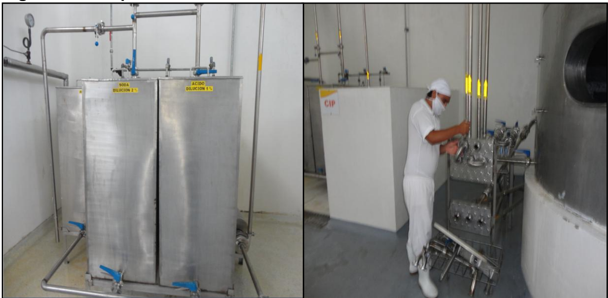
Figura 22. Tanque de CIP
