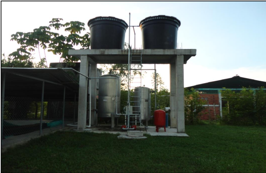
Figura 21. Tanque de agua potable
