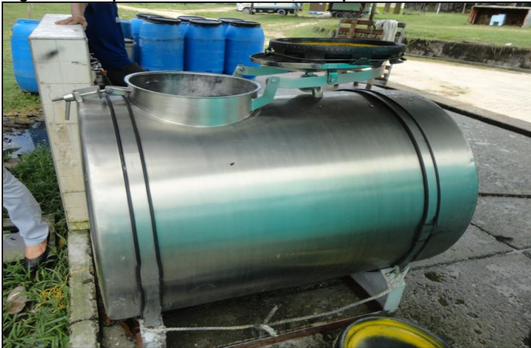
Figura 8. Tanque de almacenamiento, Cooprisa Ltda.
