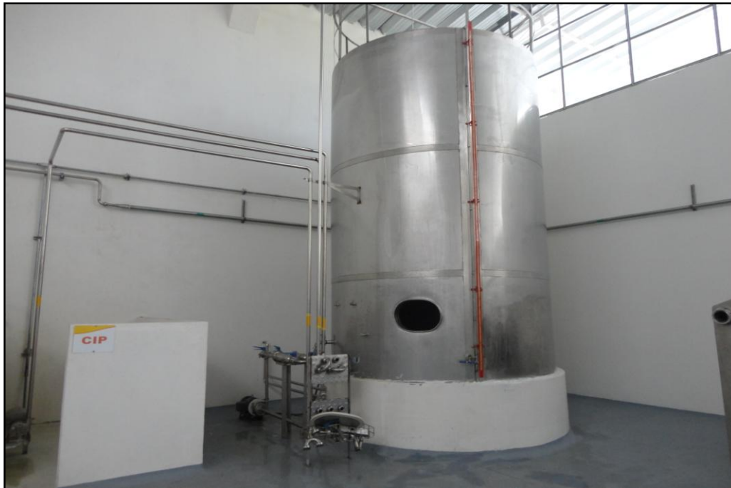
Figura 9. Silo de almacenamiento
