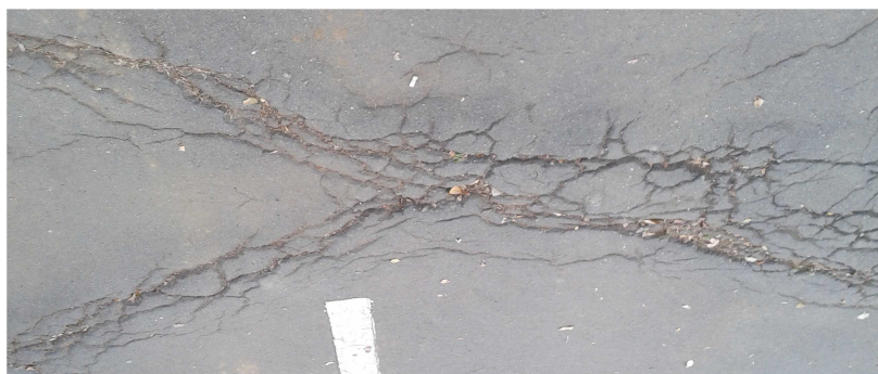
Figura 5.8: Imagen de la tercera escena, daño en el pavimento
