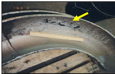
Figura 8. Corrosion por Ácidos Nafténicos.
