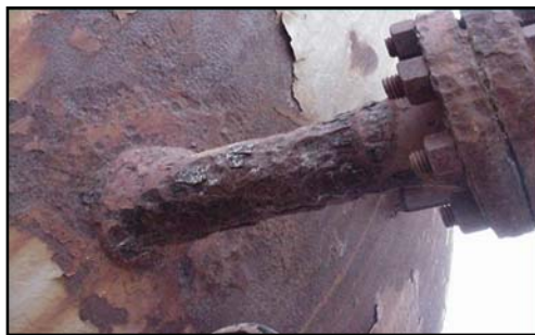
Figura 4. Boquilla con problemas de CUI en la planta U1200.
