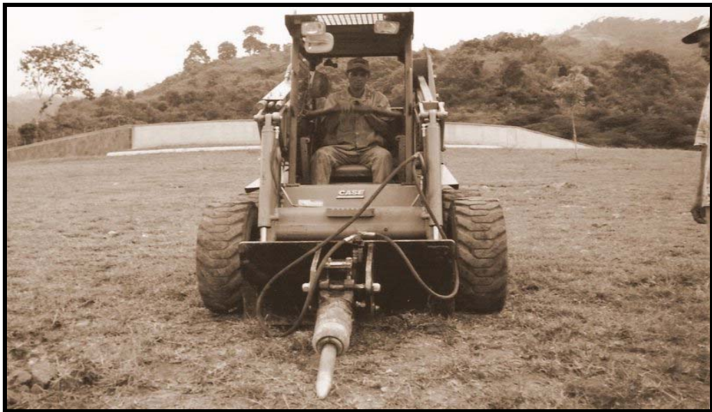
Figura 7. Maquinaria y operario en el proceso de construcción del parque cementerio a mediados de 1972.
