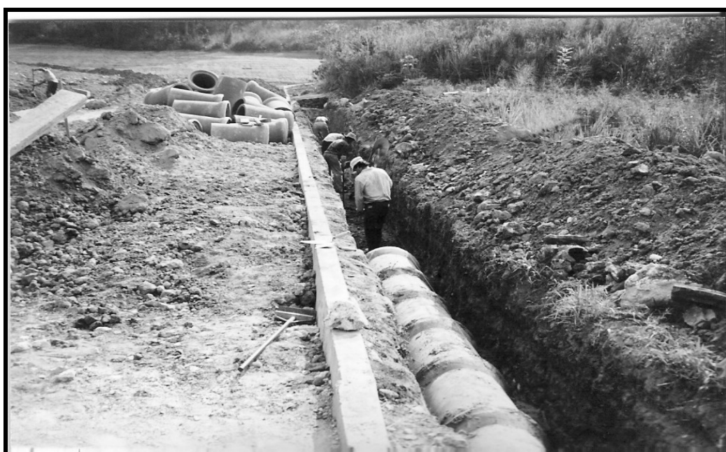
Figura 8. El sistema de drenaje para las aguas residuales y subterráneas resultantes en el Parque Cementerio.
