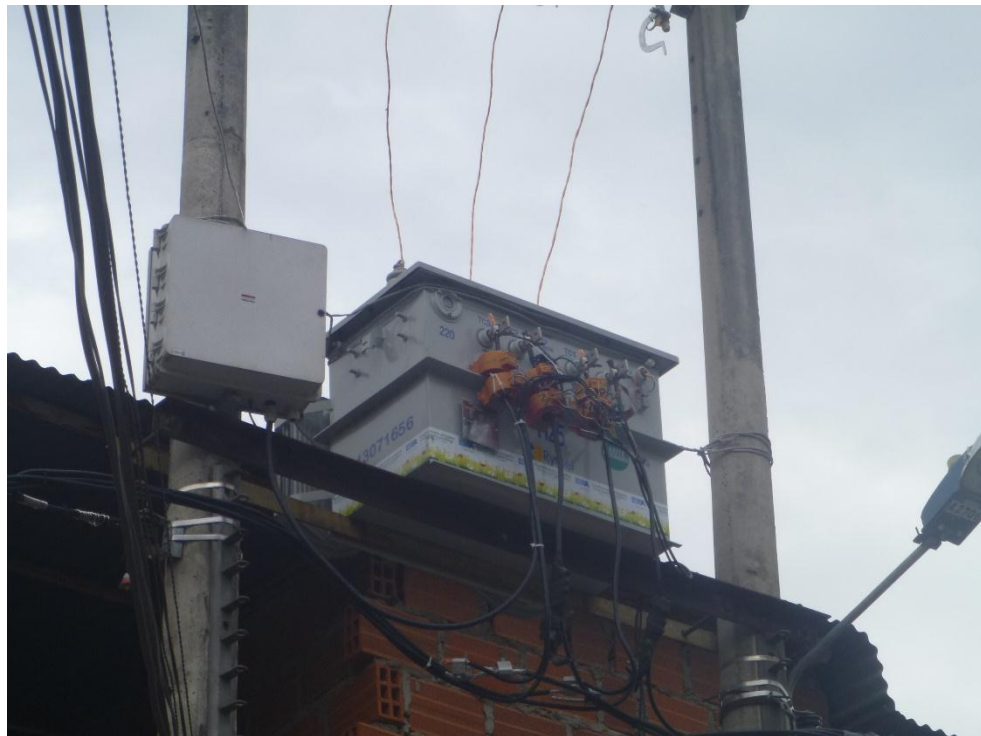
Figura 6 Transformador de distribución N° 4148
