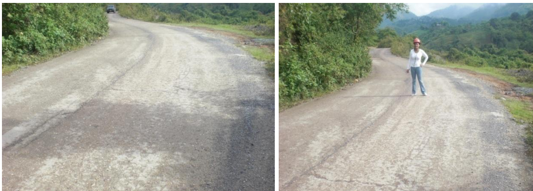
Figura 1b. Estado Actual de la vía (planta cementos diamante)
