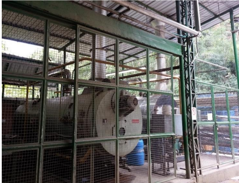
Figura 2. Calderas pirotubulares de la planta de beneficio
