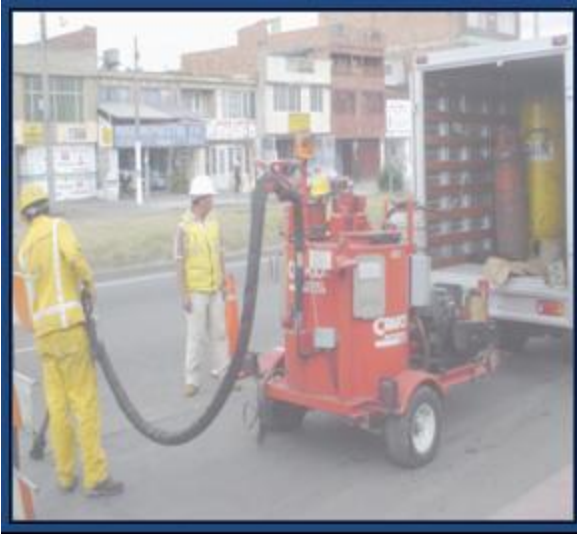
Figura 5 Sello de fisuras
