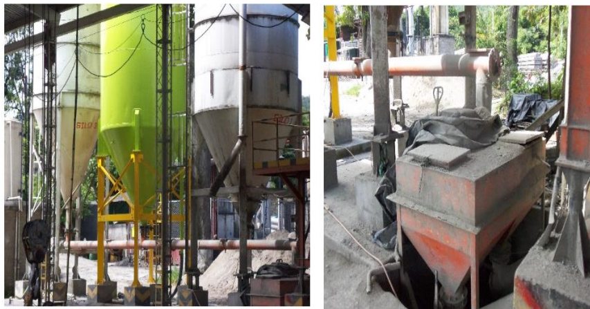
FIGURA 29 Silos y pulmón de cemento. Fuente: Autor.
