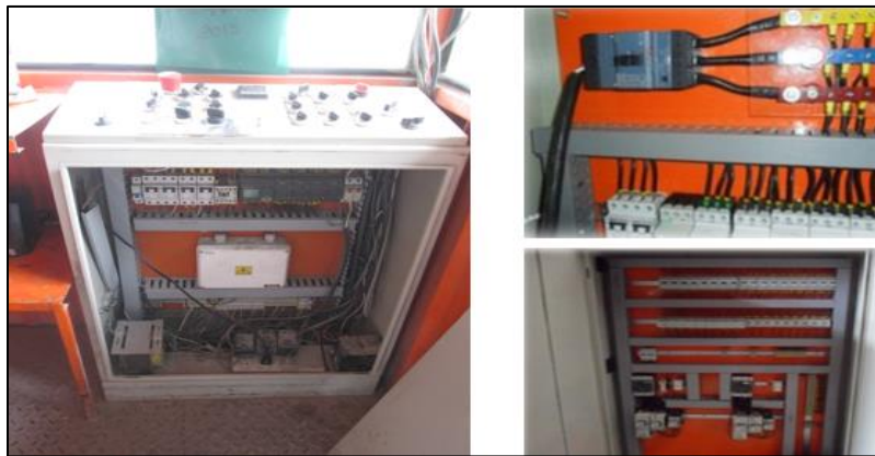
FIGURA 20 Sistema eléctrico. Fuente: Autor del proyecto.
