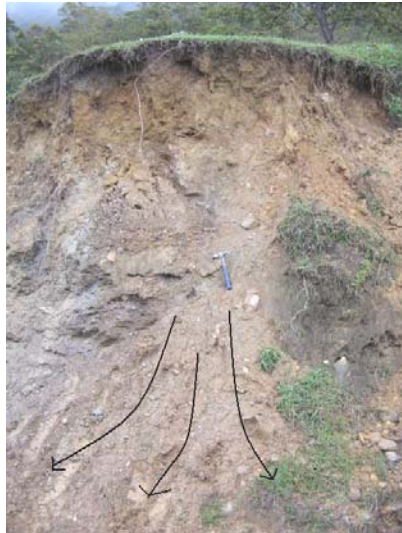
Figura 25. Deslizamientos en cárcavas del suelo debido a la alta meteorización. Presenta una granulometría arcillosa. Vía Tona- La Quincha. Formación Silgara.
