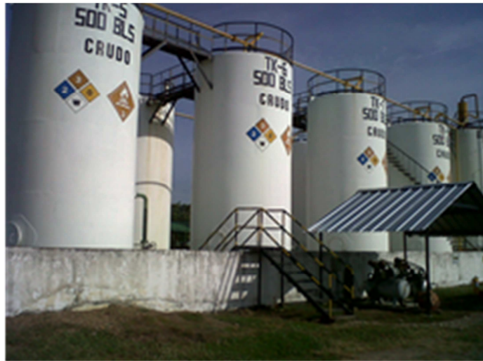
Figura. A-5. Tanque de almacenamiento de petróleo tratado campo Entrerrios
