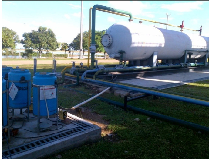
Figura. A-3 Separador general trifásico.
