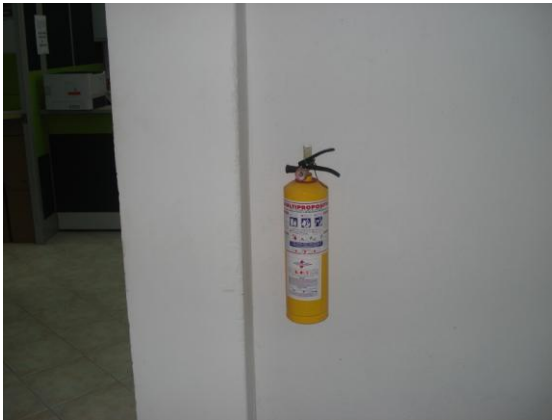
Foto 24. Señalización extintores. Antes
