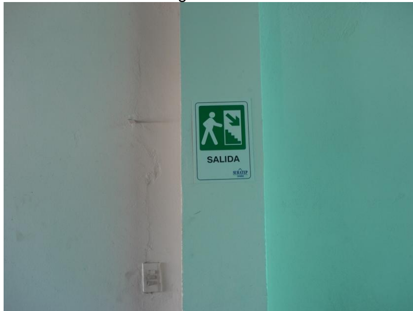
Foto 25. Señalización salida de emergencia.
