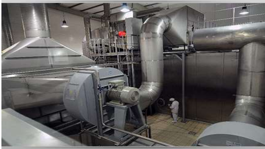
Figura 14. Plantas automatizadas (1-3 Ton/h)
