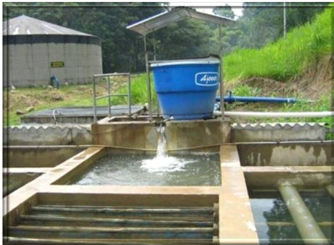
Foto 2. Planta de agua potable
