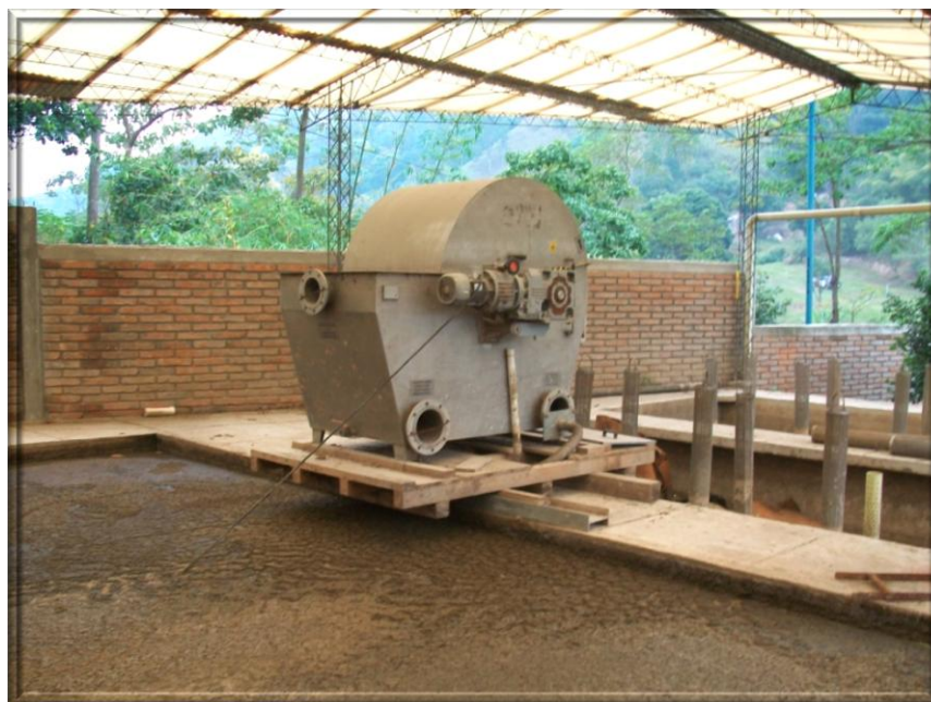
Foto 5. Separadora de lodos
